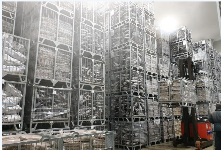
05 • ALMACÉN FRIGORÍFICO • -25 °C
